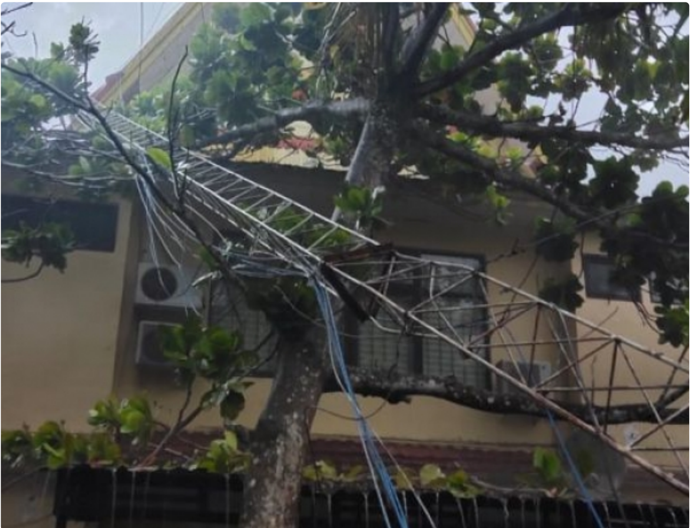
Akibat angin kencang, tower Adminduk Disdukcapil Kuansing roboh
